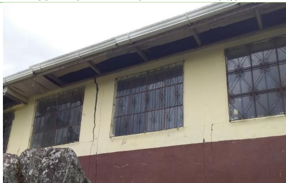
DAÑOS ESTRUCTURALES EN VIVIENDAS
