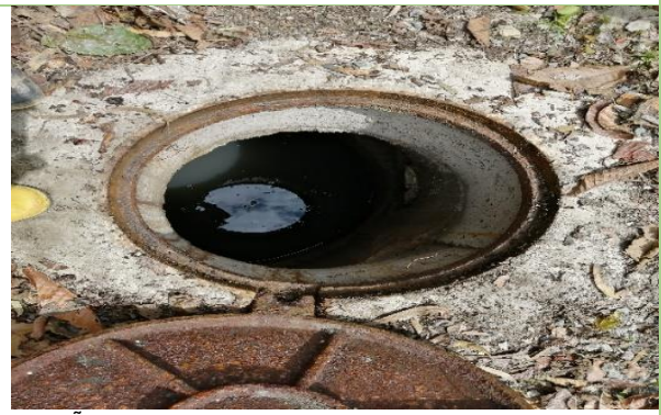
DAÑOS ESTRUCTURALES EN EL ALCANTARILLADO PARROQUIAL
