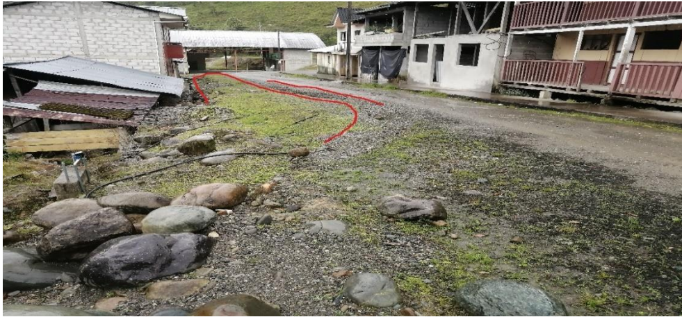
DESNIVEL A CAUSA DEL SOCAVAMIENTO.
