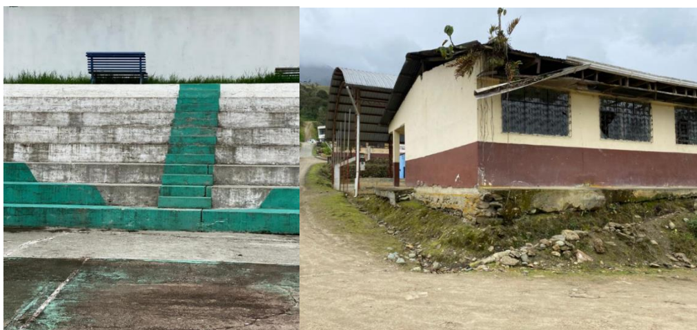
Foto 5.6: Fisuras en edificaciones
