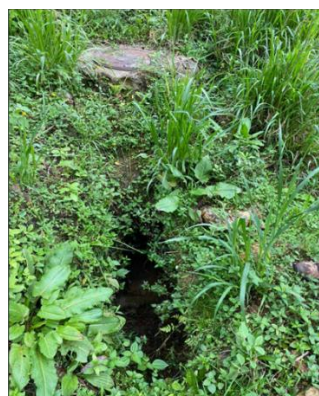
Foto 5.3: Chigüinda tubería rota por terrenos privado
