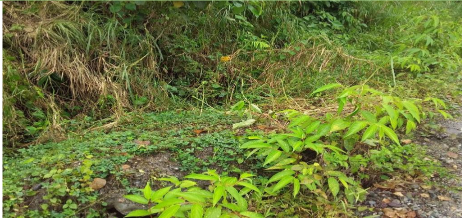
PRESENCIA DE VIA SIN CUNETAS(DRENAJE)
