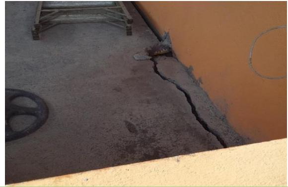
FISURAS EN VIVIENDAS ALEDAÑAS
